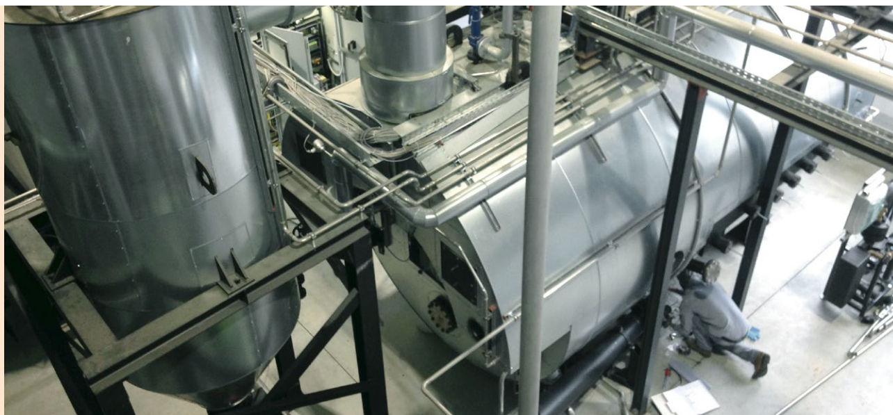
Großanlagen zur Prozesswärmeerzeugung – Beispiel hierfür die Güldenkron Fruchtsaft GmbH in Nistertal
