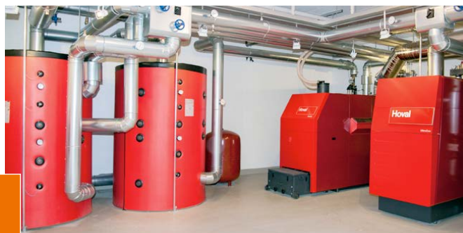
Die Heizzentrale besteht aus einem Pelletkessel (links) und einem Gas-Brennwertkessel.
